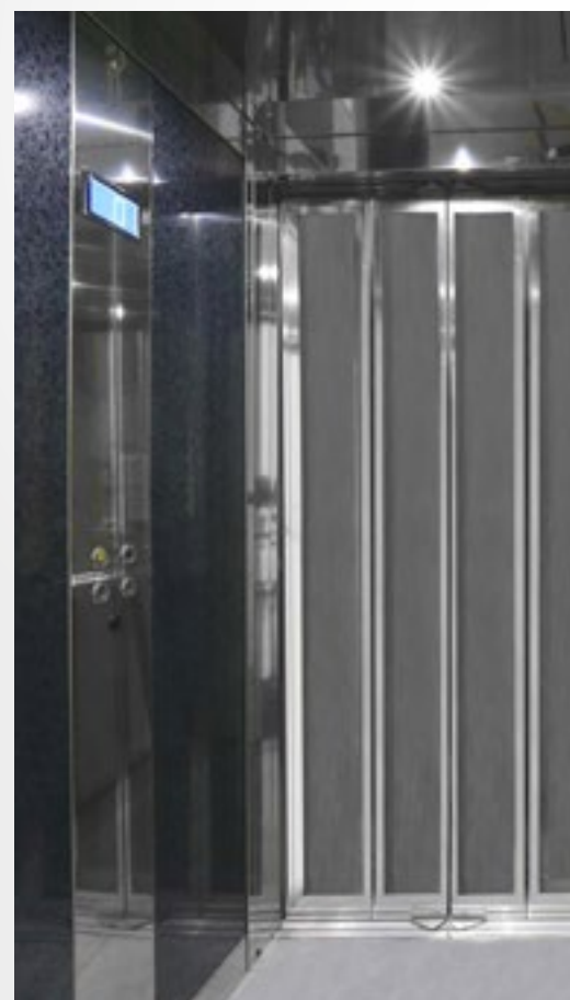
Falttür in der Kabine
